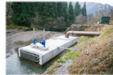
小水力発電施設
