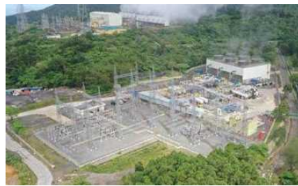
地熱発電 (フィリピン・パラヤン地区)
