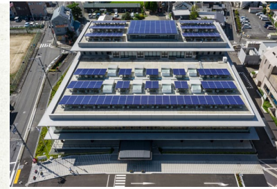
太陽光発電 (159kWh)
