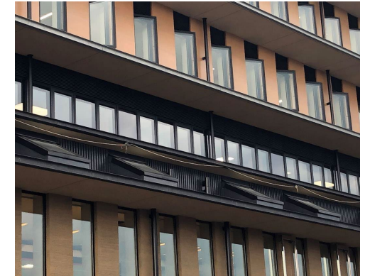
光ダクトシステムの採用
