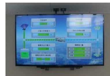
発電情報モニターの設置
